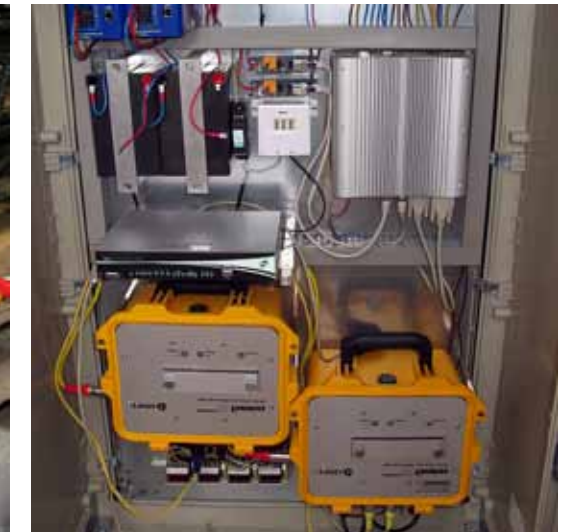
Auswerteeinheit des Monitoringsystems mit direktem Anschluss an digitales Fernleitungsnetz zur Datenübertragung.
